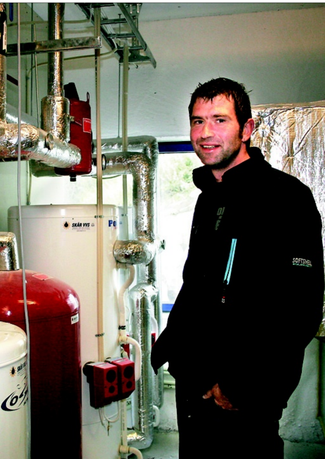
varmtvassstank, og den blir som oftast installert på vaskerommet, fortel dagleg leiar i Skår VVS, Arild Skår. Her er «pumperommet» som gir varme til Entreprenør-Begge foto: Tone Merete Lillesvangstu
